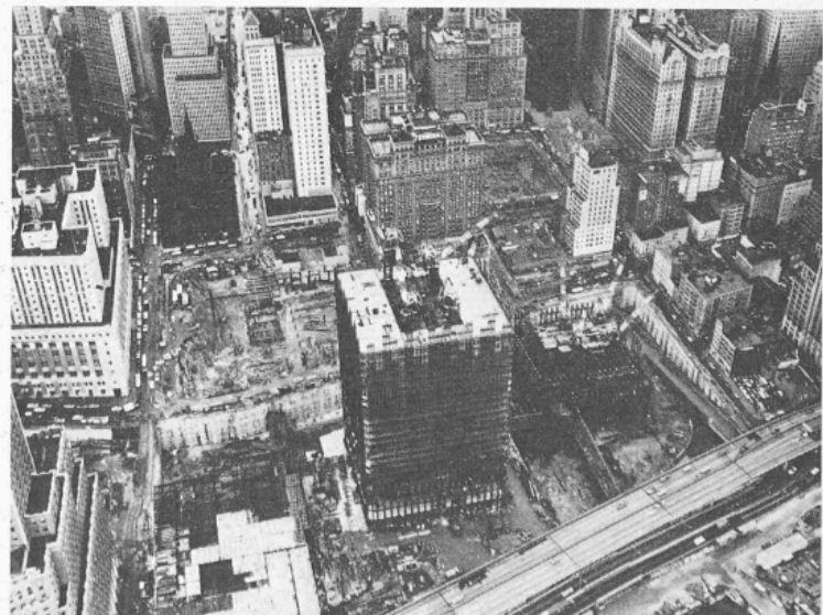
Bild 2. Ansicht der Baustelle. Der Turm rechts folgt mit etwa achtmonatigem Zeitabstand dem linken. Einige der Gebäude im Hintergrund müssen dem Handelszentrum noch weichen
