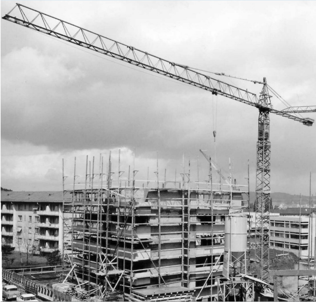
Richier Weitz X 1140 CH auf einer Baustelle in Zürich Altweg. Unternehmer Kramer.
