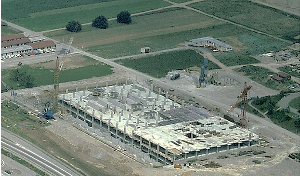
Liebherr Form 128/170 beim Bau des Tivoli in Spreitenbach (CH) 1971. Am Boden liegt ein Peiner T 125, bereit zum Aufziehen des Turms. Rechts im Bild ein Wolff Form 150 S
