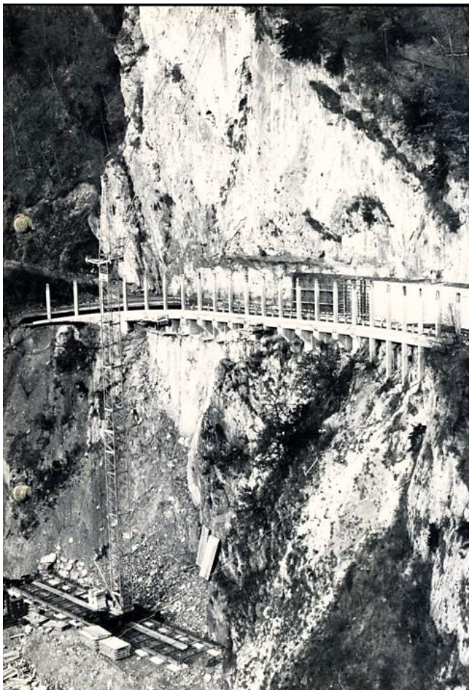
Liebherr Form 128/170 am Walensee (CH) (ARGE Mattstuck) zur Sicherung der Strasse nach Amden (CH) 1980
