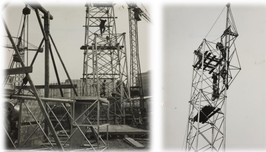
Links der Montagebock für das Vorbereiten der Kranteile, rechts der Montagegalgen im Einsatz
